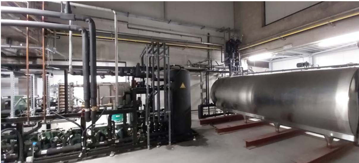
De CO 2 -centrale van de visveiling. De koelinstallatie en de scherfijsmachines werden echter volledig vernieuwd naar de natuurlijke koudemiddelen CO 2 (R744) en NH 3 (R717).
